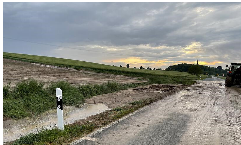
Abschwemmungen von Erdreich
