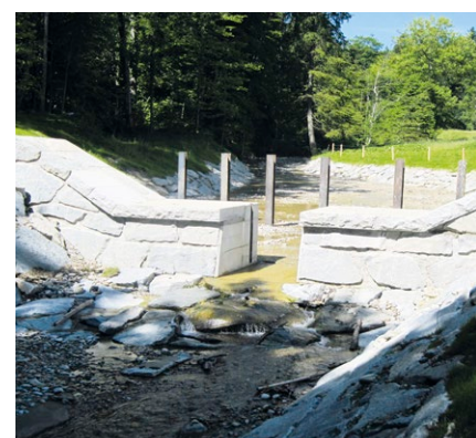
So genannte offene Wildbachsperrungen dienen der Geschiebebewirtschaftung: bei Hochwasser halten sie Kies und Geröll zurück, um die gefährdeten Siedlungsbereiche zu schützen, und bei kleineren Abflüssen lassen sie es durch, um die Bachsohle mit „Nachschub“ zu versorgen.
