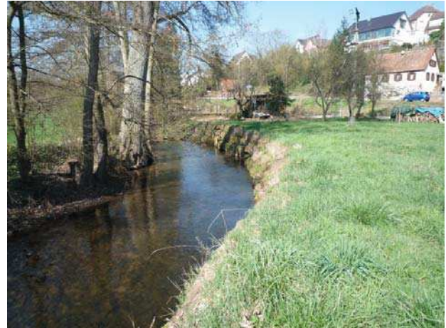
Foto Nr. 12: Spaltenreiche Mauer an der Hafenlohr im Bereich, die mit einem Erdwall zum Hochwasserschutz aufgeschüttet werden soll.
